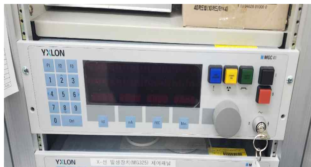
<설치된 MG-165 컨트롤러 사진>
